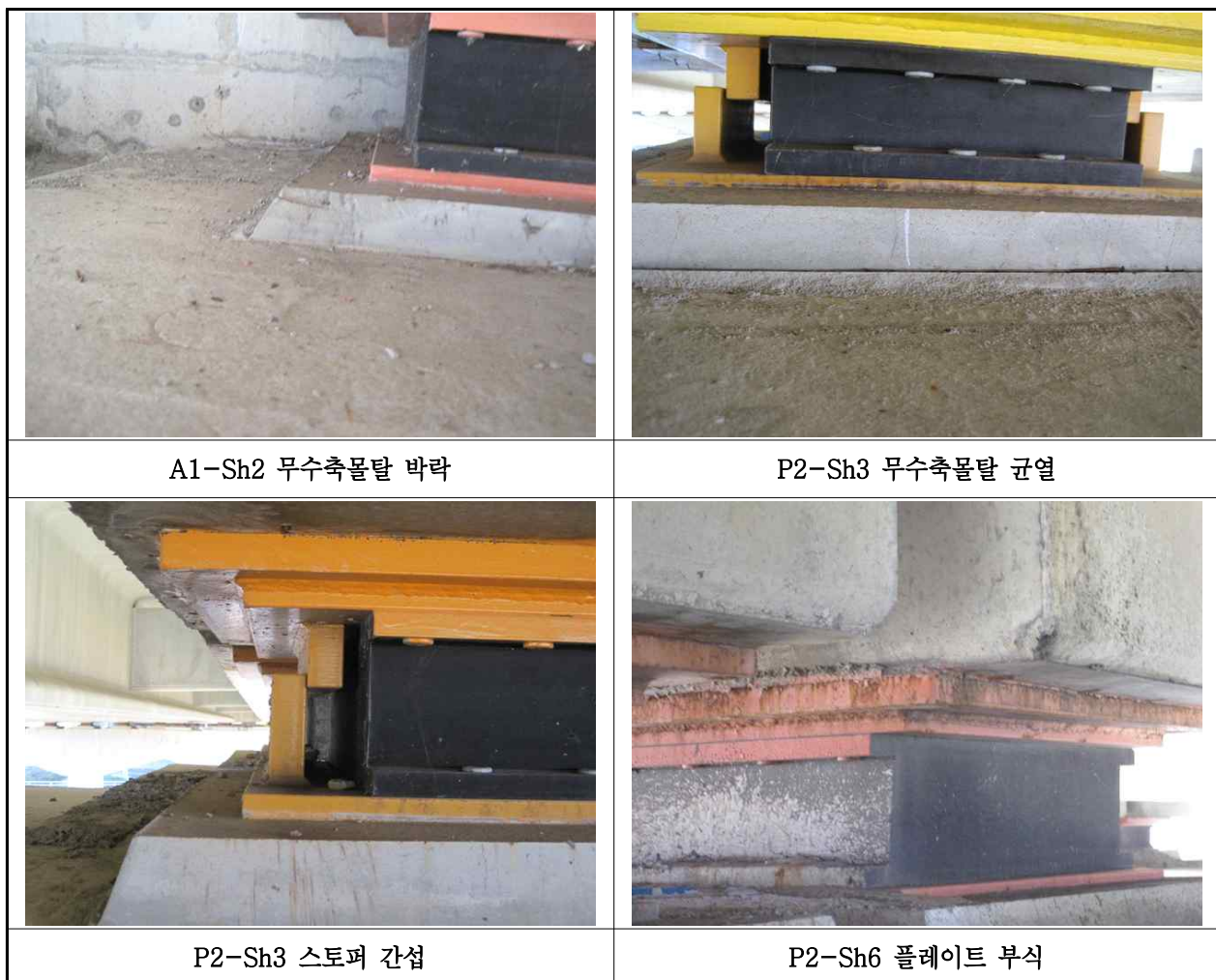
【사진 37.3.36】교량받침 손상현황
