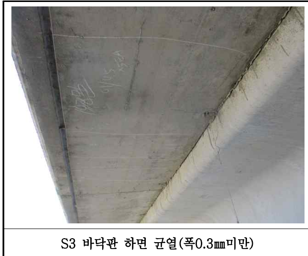
【사진 37.3.3】 바닥판하면 손상현황
