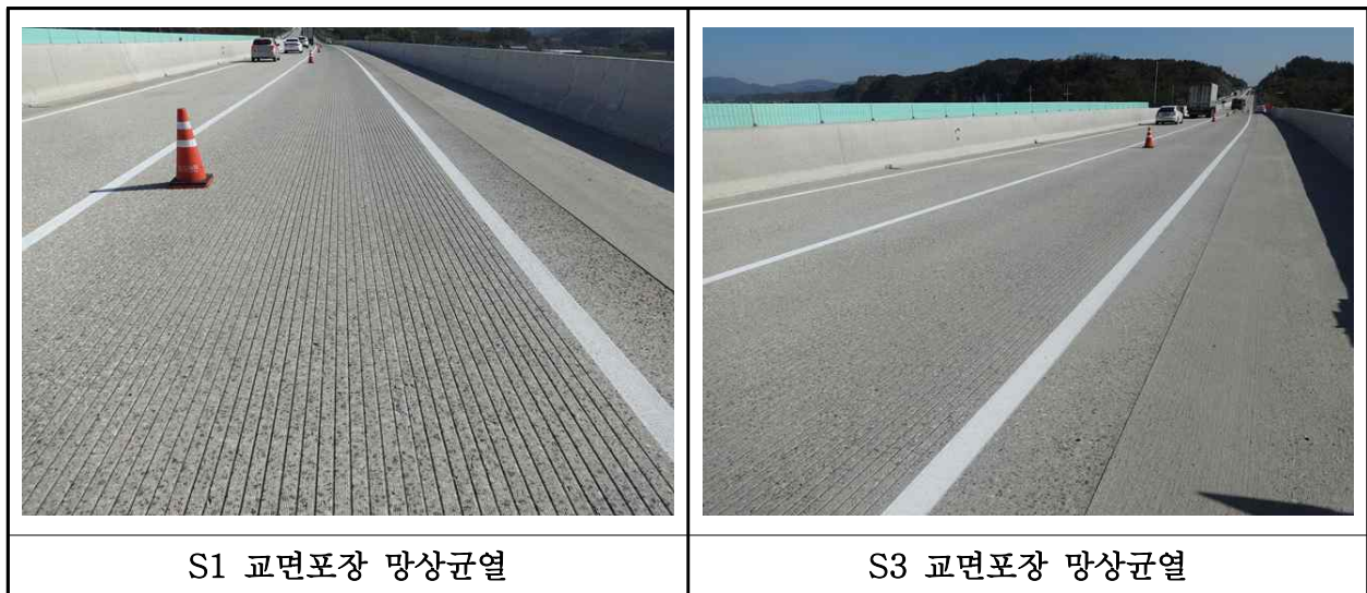
【사진 37.3.43】 교면포장 손상현황
