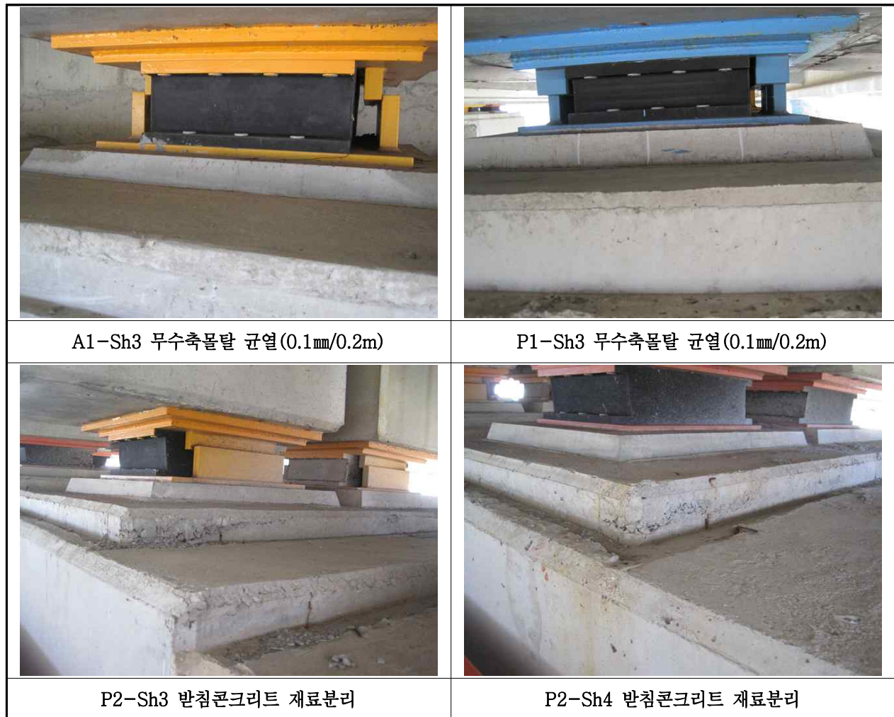
【사진 37.3.13】 교량받침 손상현황
